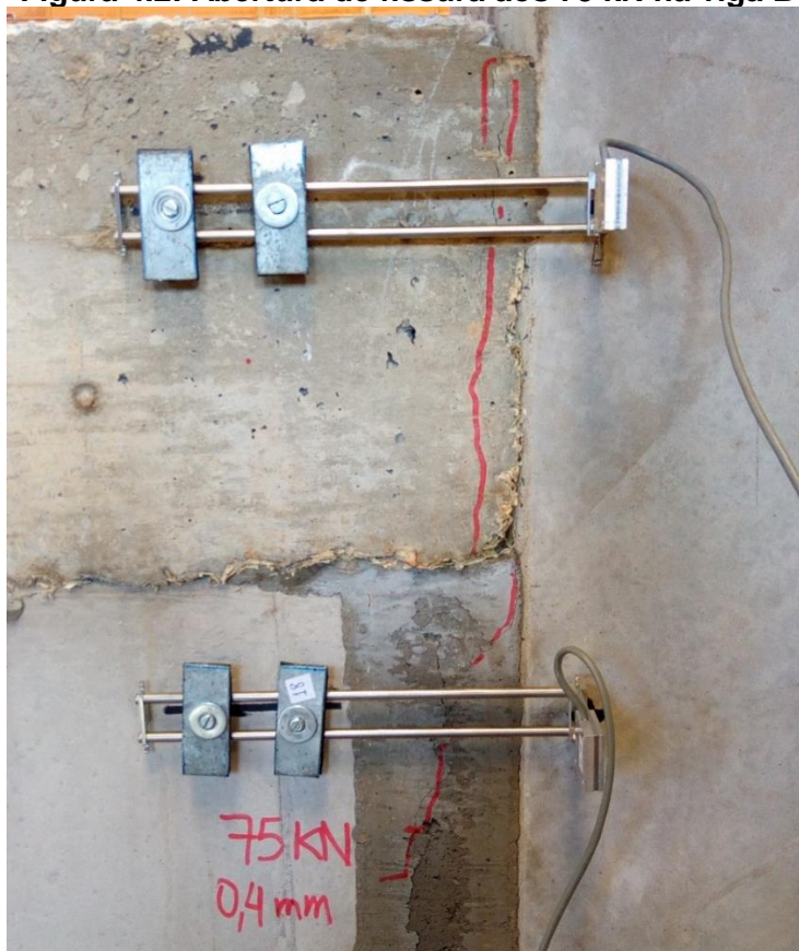
Figura 4.2: Abertura de fissura aos 75 kN na viga B
