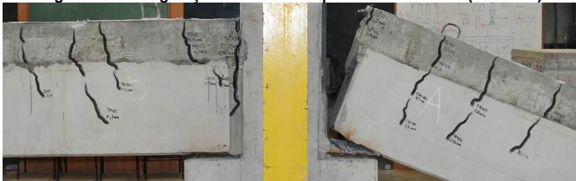
Figura 6.1: Configuração das fissuras após o fim do ensaio (Modelo 2)
