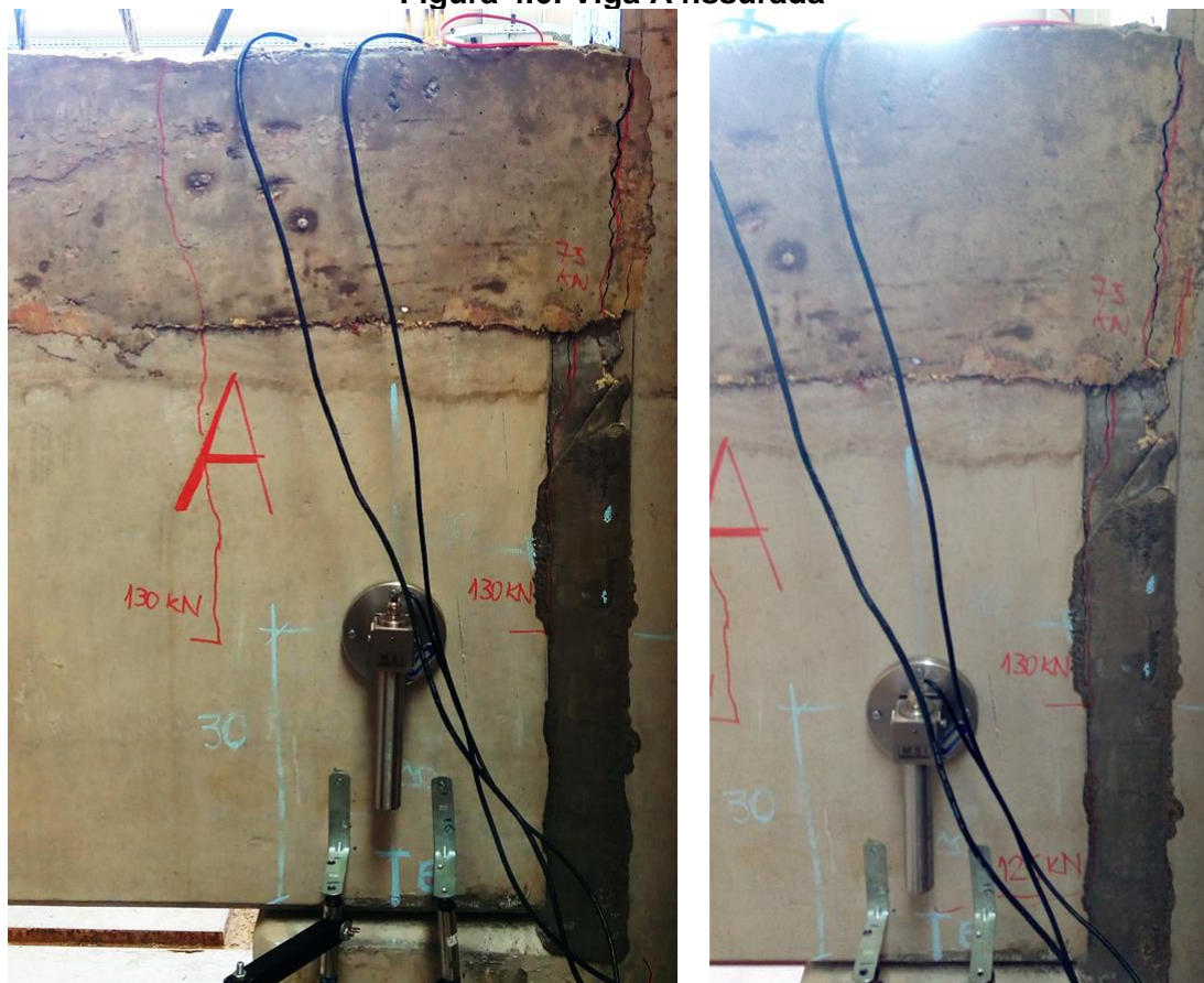
Figura 4.6: Viga A fissurada
