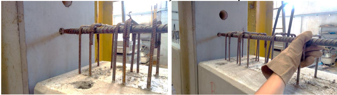
Figura C.3: Posicionamento da armadura negativa na viga B. Armadura muito desalinhada em relação à luva em espera
