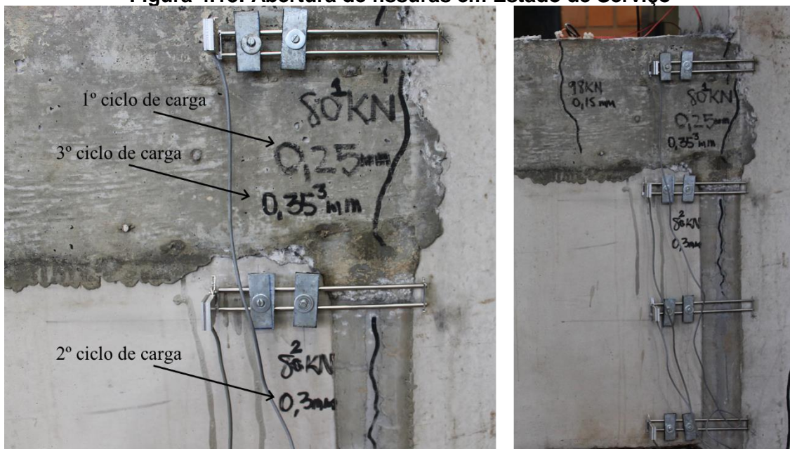
Figura 4.18: Abertura de fissuras em Estado de Serviço
