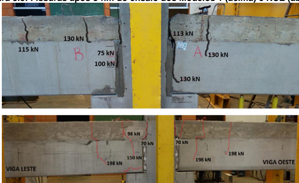
Figura 5.8: Fissuras após o fim do ensaio dos Modelos 1 (acima) e NCE (abaixo)
