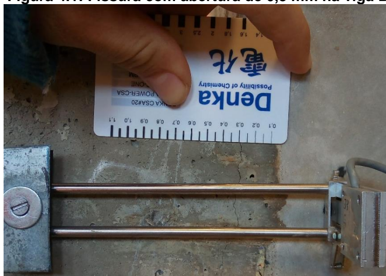
Figura 4.1: Fissura com abertura de 0,3 mm na viga B
