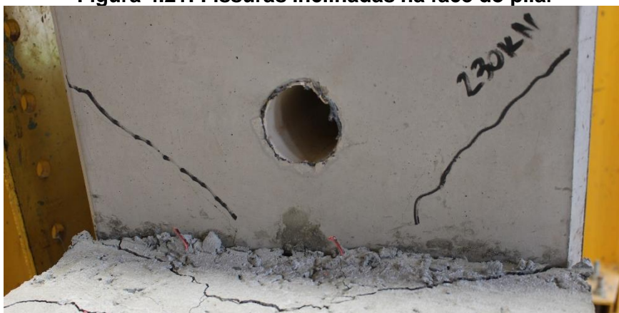
Figura 4.21: Fissuras inclinadas na face do pilar
