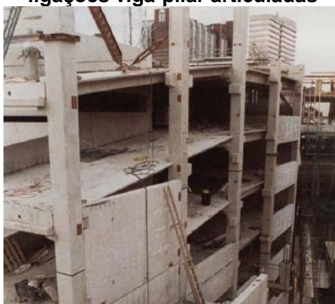
Figura 2.1: Esqueleto de estrutura pré-moldada em construção com uso de ligações viga-pilar articuladas
