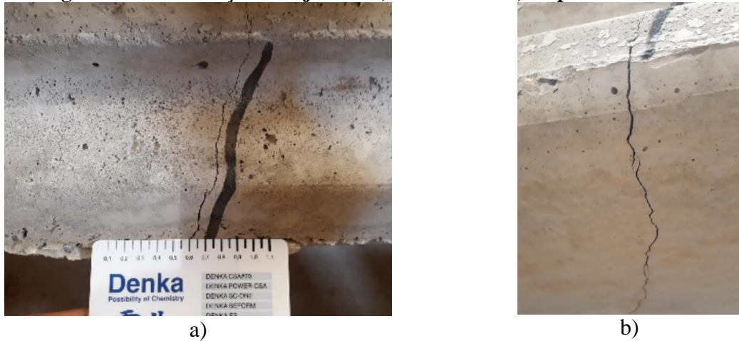
Figura 7-23: Fissuração da laje L05. a) nas laterais. b) na parte inferior
