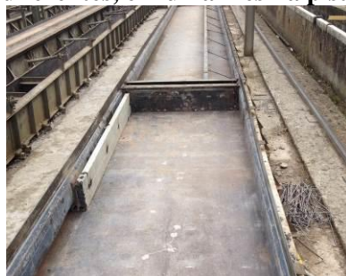
Figura 5-47: Configuração da fôrma para produção da laje alveolar moldada por fôrma fixa com larguras diferentes, em uma mesma pista de protensão
