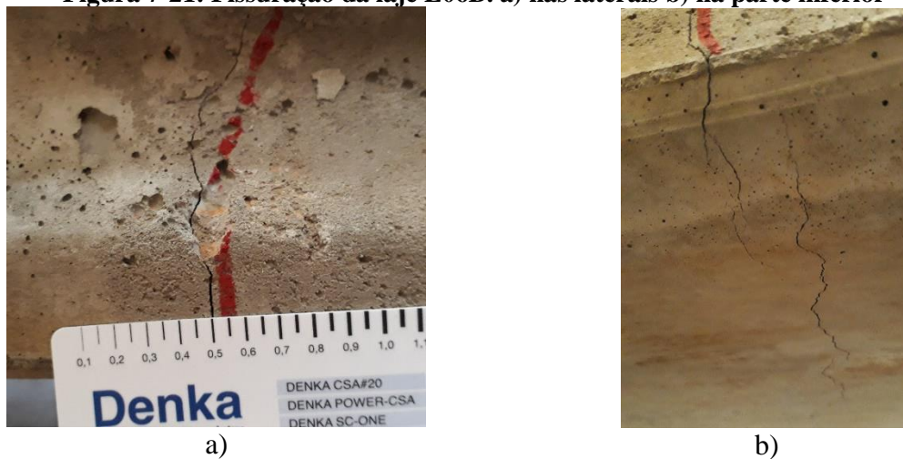
Figura 7-21: Fissuração da laje L06B. a) nas laterais b) na parte inferior
