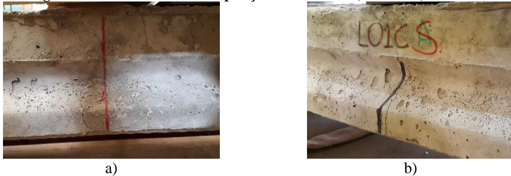
Figura 7-26: Fissura abaixo da posição do atuador: a) L01SE b) L01CE
