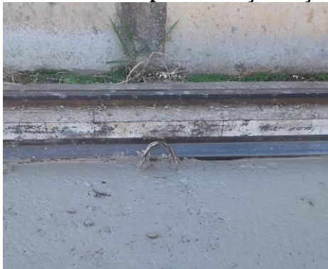
Figura 5-56: Parta exposta da alça de içamento
