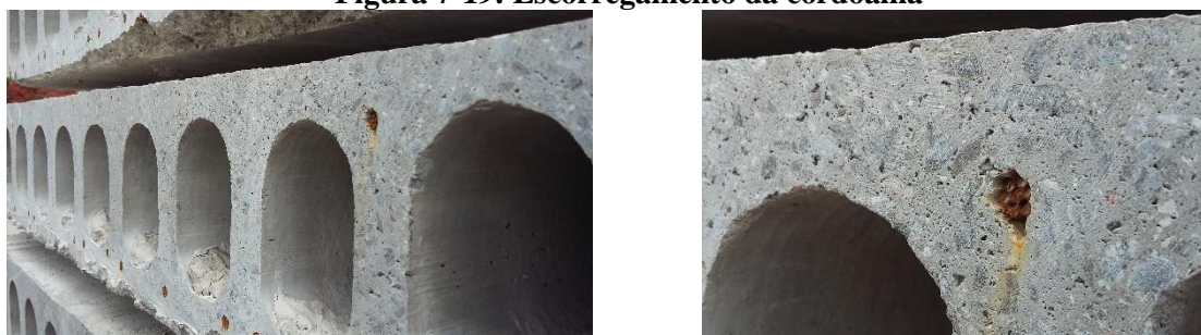
Figura 7-19: Escorregamento da cordoalha
