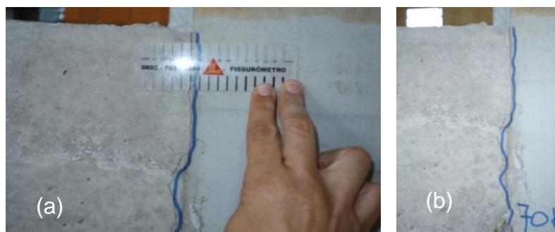
FIGURA 4.5 – Medida de fissuras através de fissurômetros ao longo do ensaio – NCE
