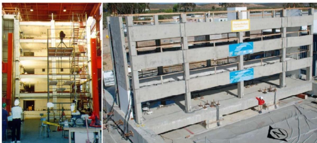
FIGURA 2.4 – Estrutura em esqueleto ensaiada durante o projeto de pesquisa PCI – PRESS (esquerda) e a Metodologia de projeto sísmico do diafragma testada na Universidade da Califórnia em San Diego (direita).
